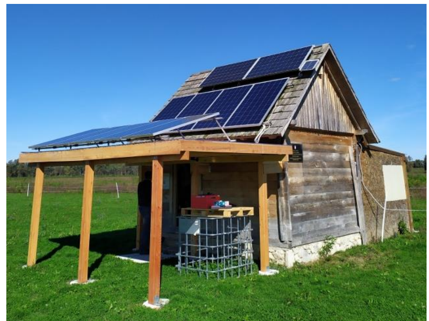
-napajanje iz solarnih panela 31
